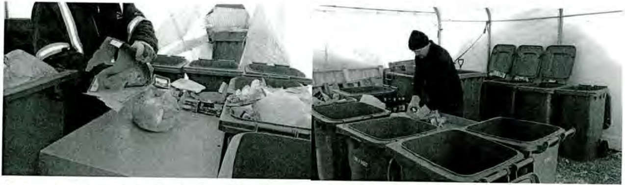
Photographie 6: Centre de transbordement de 20 pieds par 20 pieds avec des bacs et table de tri (source : Pierre-Luc Dessureault, Chaire en éco-conseil)
